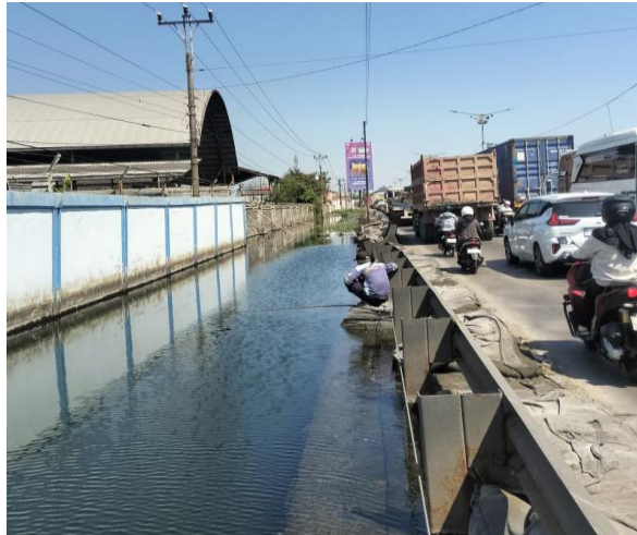
Gambar 6 Saluran Drainase Hilir Segmen 1 STA 0+295 6°56'41.93``LS dan 110°29'51.49``BT (Sumber : Dokumentasi Pribadi)
